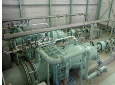
排水機場内状況
