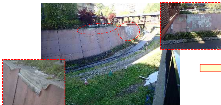
工事前の状況 (護岸老朽化による前面塗装の剥落)
