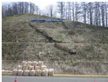
供用開始後に発生したのり面変状
