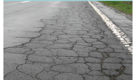
支持力低下ひび割れ 原因：軟弱な路床土・凍結融解
