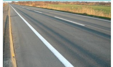
わだち掘れ 原因：車両走行による摩耗・流動
