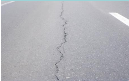
凍上ひび割れ 原因：路床土の凍上
