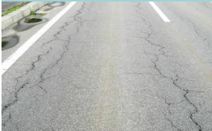
疲労ひび割れ 原因：車両の走行荷重
