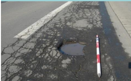
ポットホール 原因：ひび割れの進行
