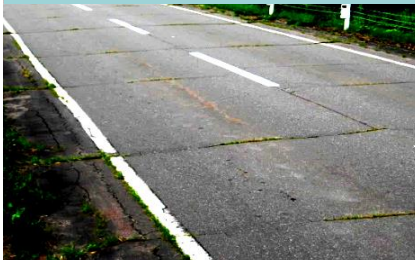
低温ひび割れ 原因：低温による収縮
