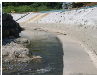
暫定施工中に生じた河床低下と護岸工変状
