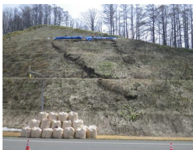
供用開始後に発生したのり面変状
