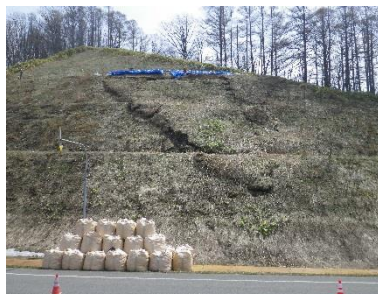
供用開始後に発生したのり面変状
