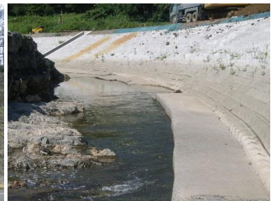
暫定施工中に生じた河床低下と護岸工変状
